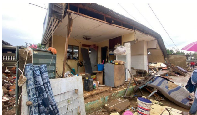
Picture 3: Dégâts causés par les inondations de juin 2022 à Bingerville
